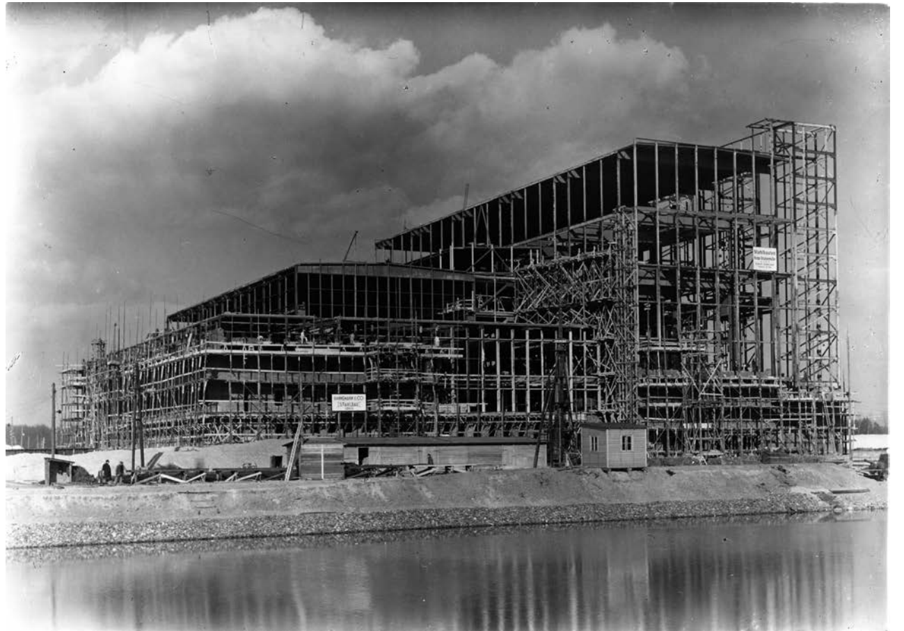
Abb. 1: Das Kraftwerk im Aufbau, „Stadt des KdF-Wagens bei Fallersleben“ 1938, Fotograf unbekannt; Bildersammlung IZS
