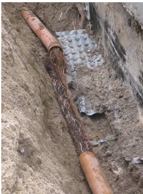
vollständiger Rohrverschluss durch Wurzeleinwuchs
