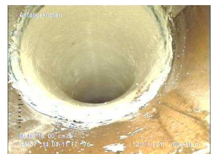
verklebter Kurzliner in einem Abwasserrohr
